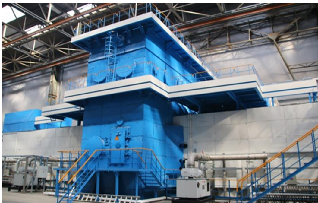
Рисунок 1 - Установка ЭЛУ 24-16М
