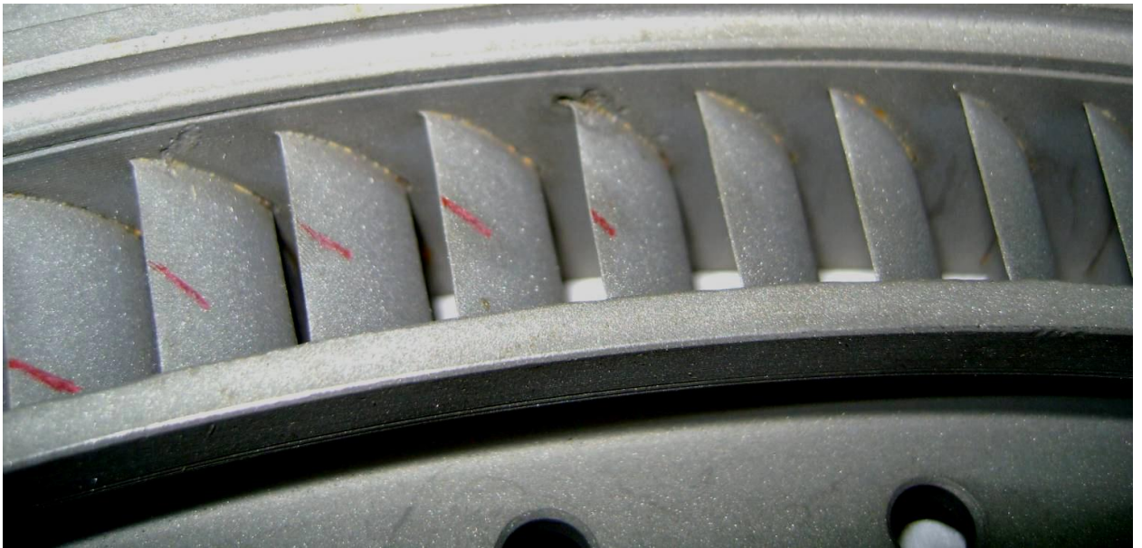
Рисунок 2 – коррозия на спрямляющем аппарате
