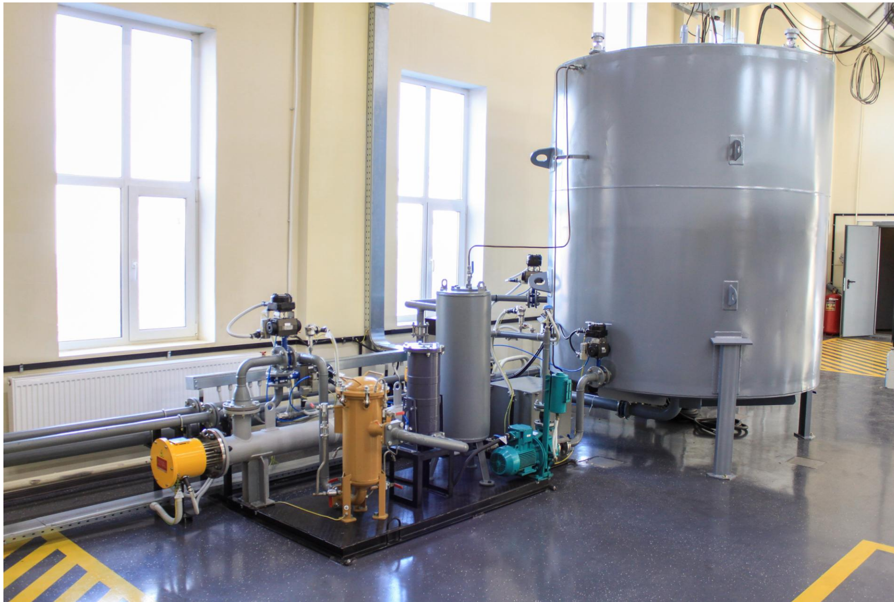
Стенд топливной системы СТ21-1. Комплекс КТО1-1. Технологический блок хранения, фильтрации и подогрева топлива.
