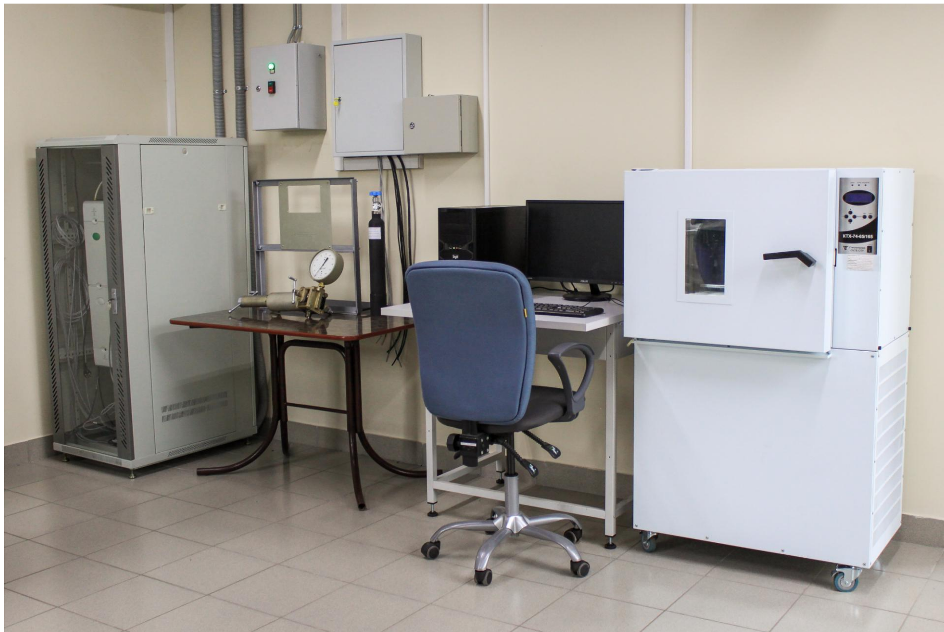
Стенд силовой автоматики ССА. Рабочее место управления технологическим процессом испытаний элементов топливных систем.
