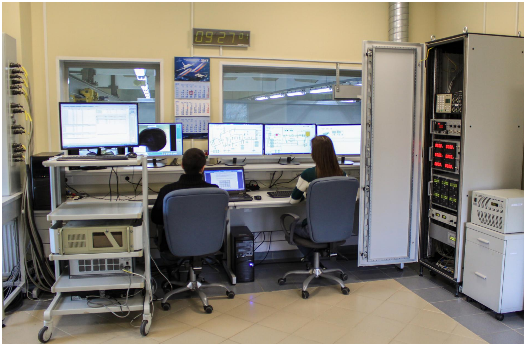
Стенд топливной системы СТ21-1. Рабочие места персонала по управлению технологическим процессом испытаний топливных систем при проведении испытаний топливной системы самолета МС-21.
