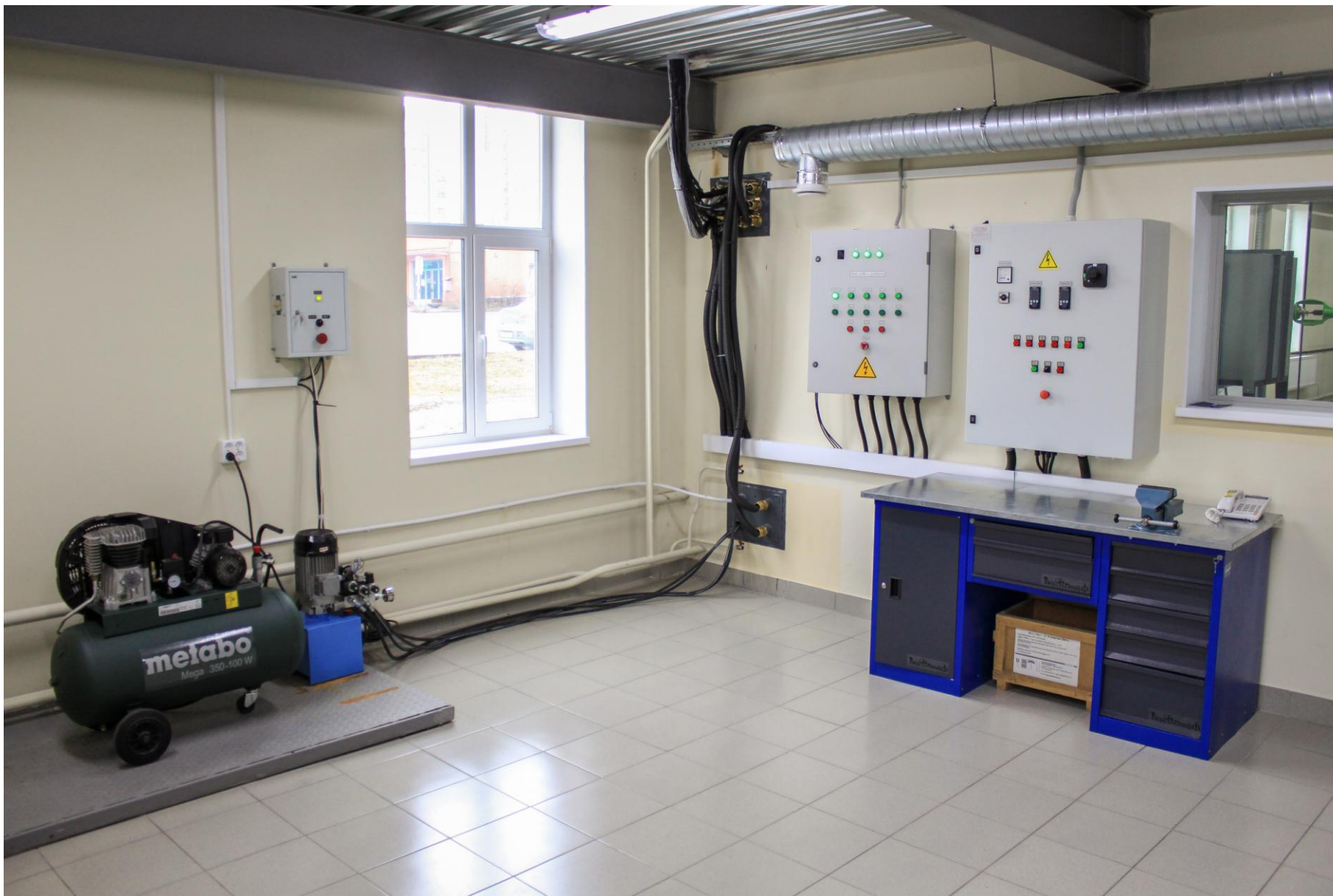
Испытательный комплекс топливных систем и их компонентов. Помещение аппаратной с технологическим оборудованием комплекса КТО1-1 и платформы ППБ1-1
